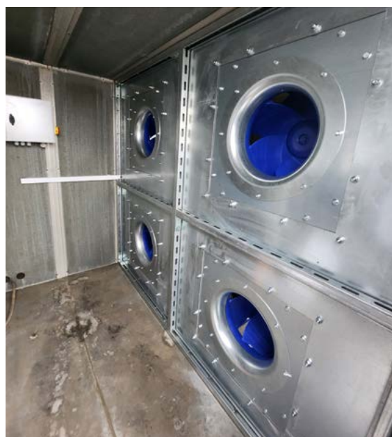
Fot. 1, 2. Układ po modernizacji: nowoczesny system wentylatorów z napędem bezpośrednim, wyposażony w silniki elektronicznie komutowane (EC).
